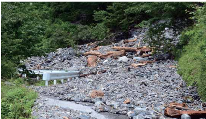
白髪避難小屋南面から崩れ落ちた土石 (2012年)
