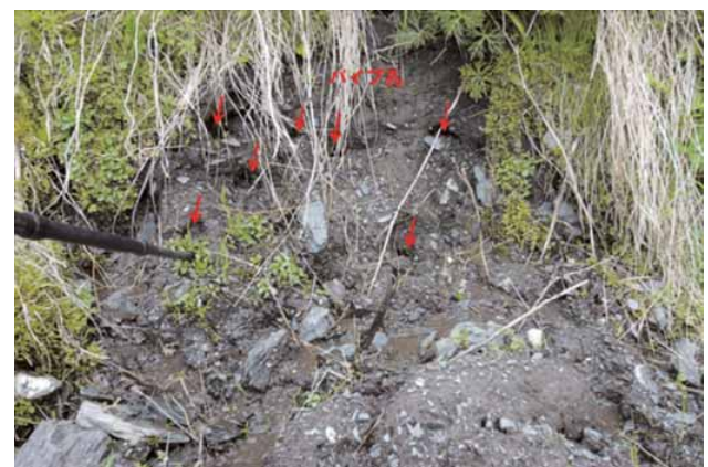
図6 虫食い状侵食で露出した土壌。 多数のパイプ孔から土砂が流出している。
